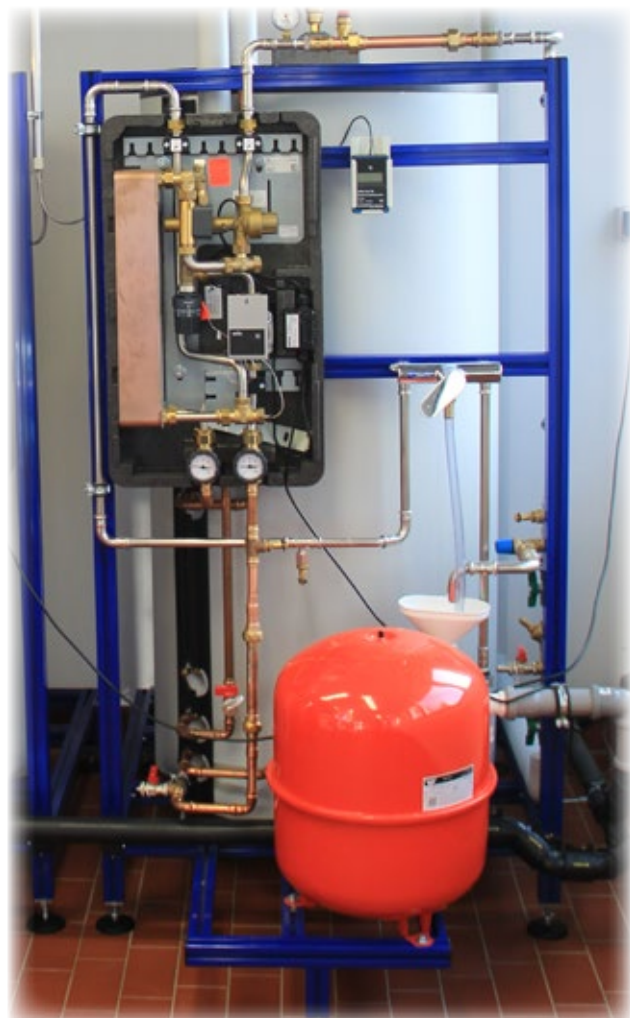
Kundenspezifische Lösung zur Energiespeicherung
