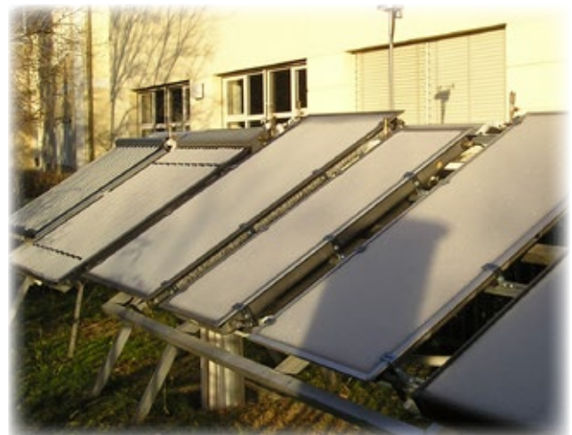
Versuchskollektoren mit gemeinsamer Neigungsverstellung
